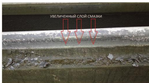
Рис. 1. Слой смазки, нанесенный воздушно-капельным путем на боковую поверхность остряка, после пропуска состава
