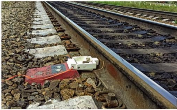
Рис. 1. Оснащение бесстыкового пути контролирующим устройством КСТП-01
